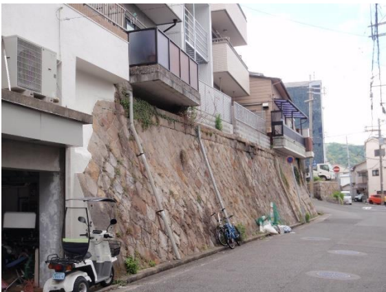
旧湊川の堤防(石垣高さ6m)の上に建つ住宅 かつてはこの上を旧湊川が流れていた。
