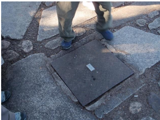
鉄板の蓋で覆われている
