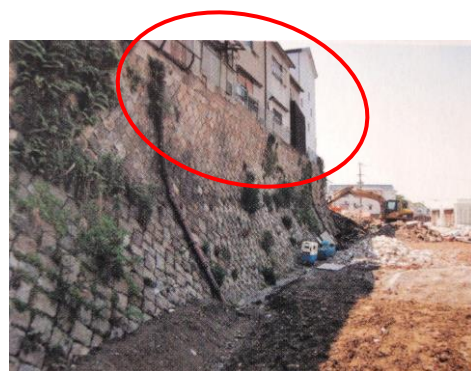
3年前、擁壁と住宅が崩落事故を起 こした現地の写真(写真は新之介氏着 「高低差」地形散歩より借用)
