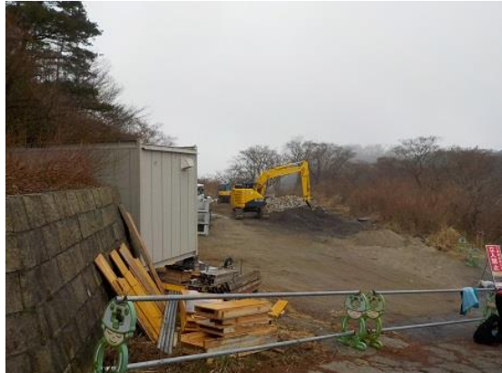
17. 広場では新しいバイオトイレ建設のための資材が運び込まれていた。神戸市により秋頃には完成するとのこと
