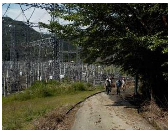
2. 規模がドデカくて圧倒されるような変電所の横を通過する
