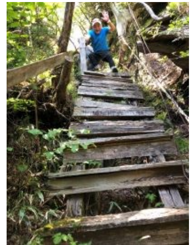
15 木の階段も劣化。
